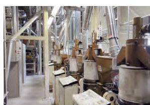
MDA除電設備の特定米穀精米機 クボタ3連座精米機
