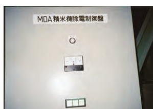
MDA精米機除電制御盤
