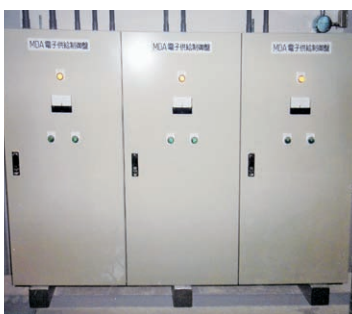
MDA電子発生制御盤
