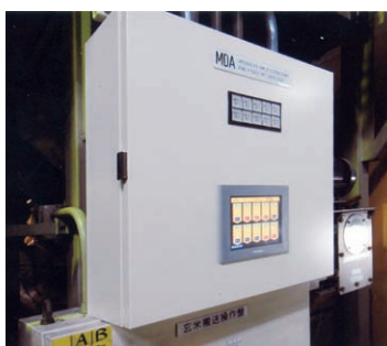
MDA酒米処理操作盤
