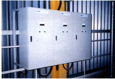
MDA 電子発生制御盤
