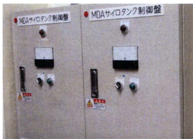
MDA 電子発生制御盤
