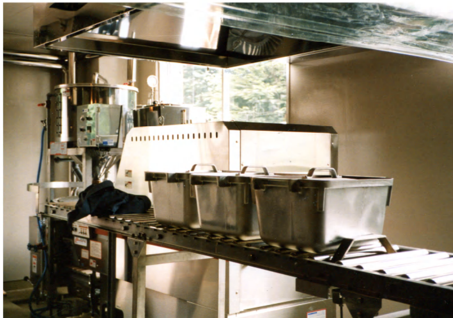
10釜連続炊飯テストラインの釜コンベヤー据付状況 AiHO製自動連続炊飯ライン
