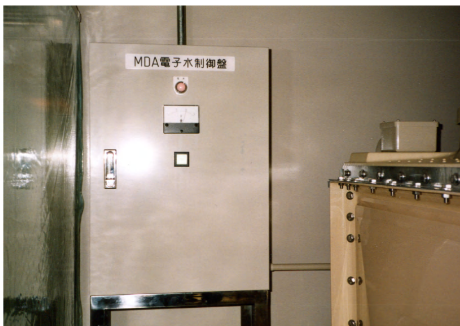
MDA電子水制御盤右はイオン水タンク
