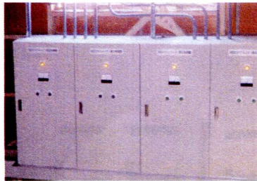
MDA電子発生集中制御盤
