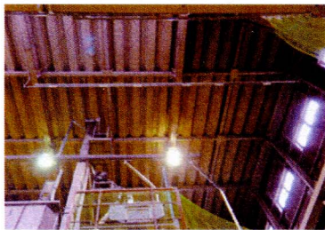
MDA電子シャワー空気浄化装置 (包装パック詰ライン)
