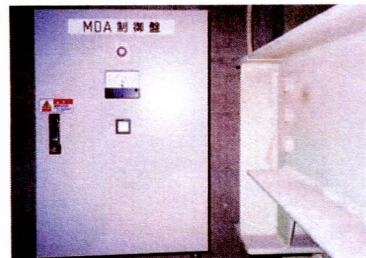
MDA電子発生制御盤
