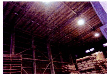
MDA電子シャワー空気浄化装置 (玄米原料倉庫)
