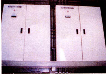
MDA精米機電子供給制御盤 (左はうるち米用、右はもち米用)
