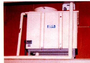
MDA電子水製造タンク (MDAマイナスイオン帯電水)
