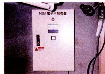
MDA電子水制御盤
