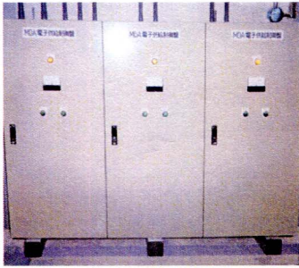
MDA電子発生制御盤
