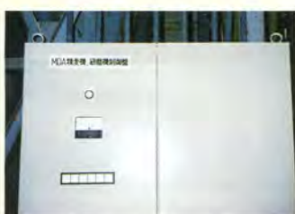
MDA静電気除電制御盤
