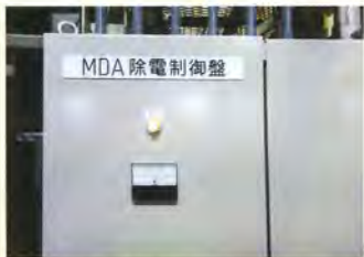
MDA静電気除電制御盤
