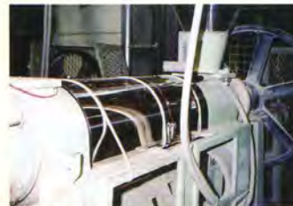
エンゲルに設置した静電気除電電極板
