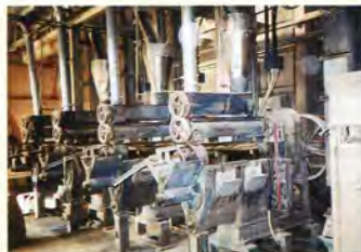
MDA設備のエンゲル研磨ライン
