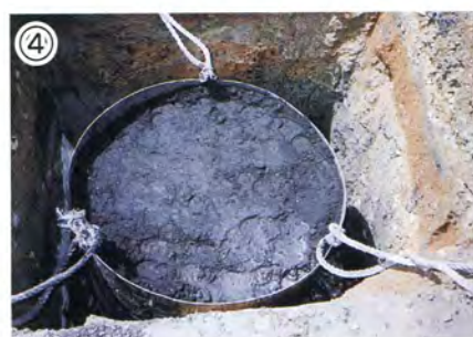
④ 規定量の炭素を金枠の中に入れて終わったら金枠の外側に残土を入れて固める。
