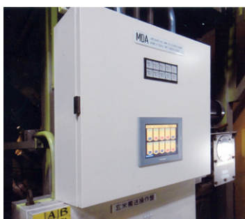
MDA玄米処理操作盤
