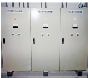
MDA電子発生制御盤
