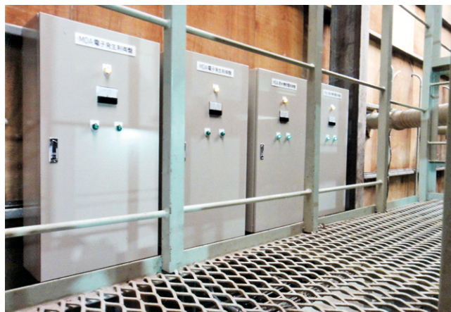
MDA電子発生制御盤
