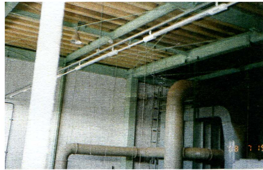
天井部に電子シャワー空気浄化装置を設置
