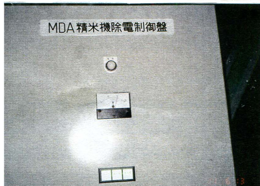
精米機静電気除電 MDA 制御盤
