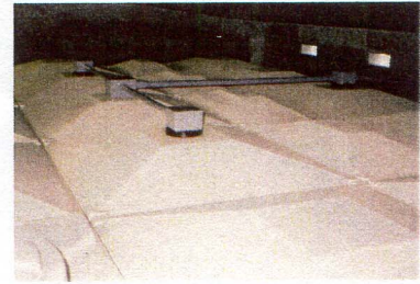
MDA電子水製造タンク上部MDA電極 取り付け状況。
