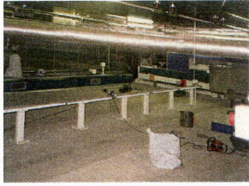
第一発酵室内の天井に設置された電 子シャワー空気浄化装置。
