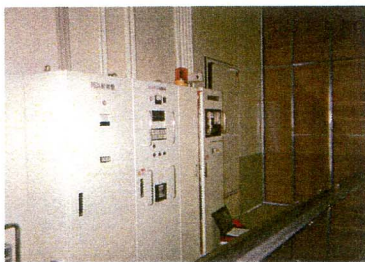
MDA発酵ボックス制御盤
