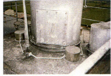
小麦粉サイロタンク上部MDA電極取付部雨よけカバー取り付け状況。
