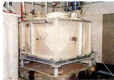
絶縁された仕込み水タンク
