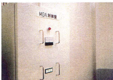
MDA電子シャワー空気浄化制御盤 （ファイナルプルファー室）
