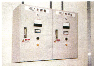
MDA液糖タンク制御盤
