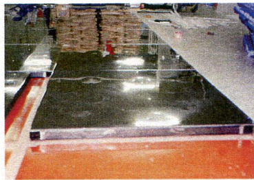
MDA電極原料台設置状況。
