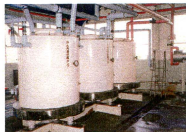
絶縁された仕込み水タンク
