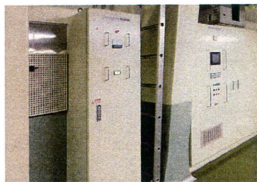
MDA副資材制御盤
