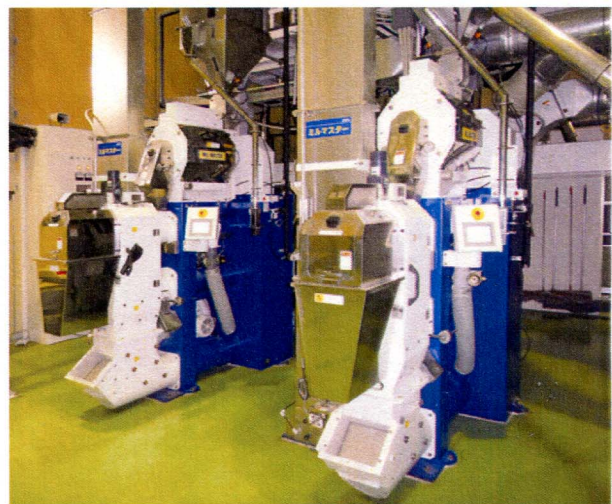
主食米の精米機に設備されたMDA静電気除電装置（参考写真）
