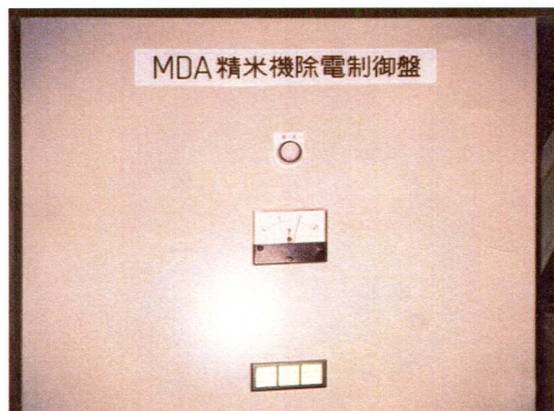
MDA精米機除電制御盤
