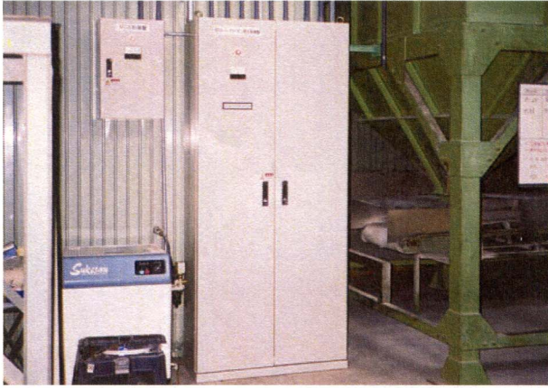
うるち玄米用自立型制御盤 MDA電子発生機集中収納制御盤。10台収納
