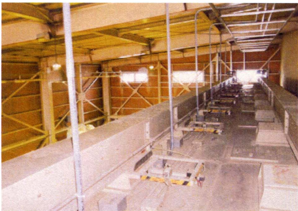
うるち玄米タンク上部MDA電子配管状況
