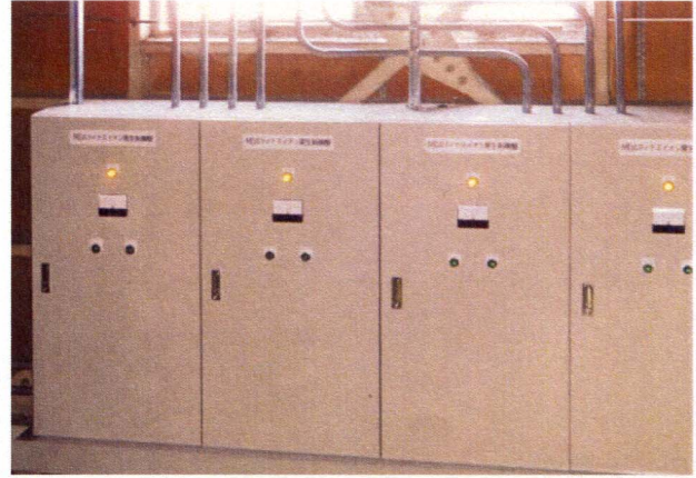
白米・もち玄米・パレット用カベ掛型制御盤 MDA電子発生機集中収納制御盤。8台収納
