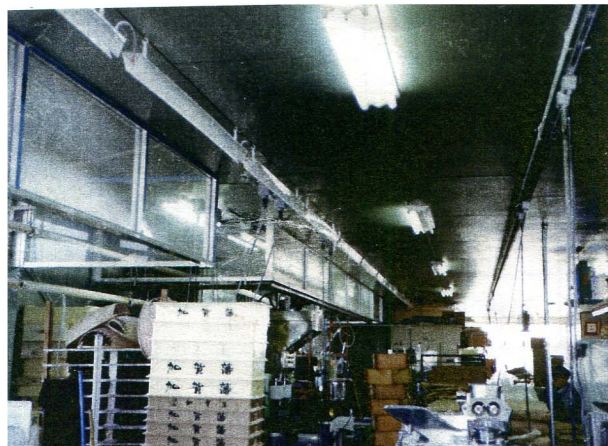
工場内MDA電子シャワー空気浄化装置取付状況
