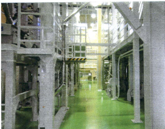
MDA電子シャワー空気浄化装置・全工場内に装置
