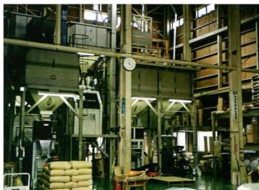
MDA設備による 透き通った空気の(株)米屋の工場内（石川）
