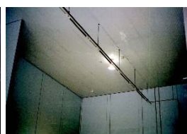
天井空気浄化装置
