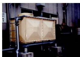
イオン水製造装置
