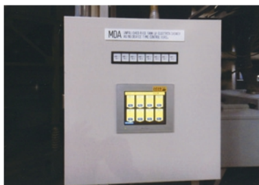
MDA酒米タンクタッチパネル操作盤
