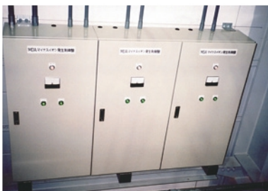
MDA酒米タンク集中制御盤
