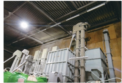
原料投入口天井に電子シャワー空気浄化装置を設備
