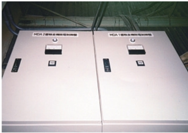
MDA色彩選別機静電気除電制御盤
