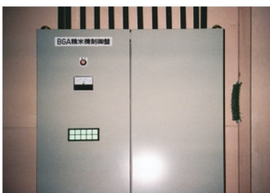
MDA酒米機静電気除電集中制御盤
