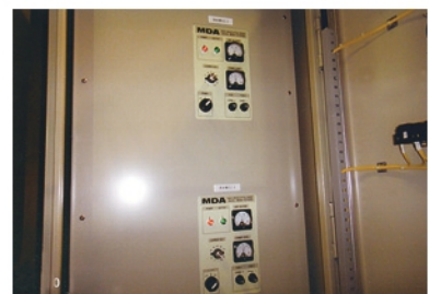
MDA制御盤内部静電気除電本体
