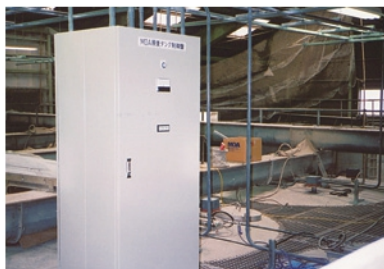
MDA原料タンク電子供給集中制御盤
