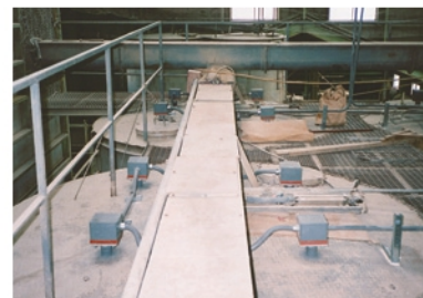
原料タンク上部MDA配管状況。
