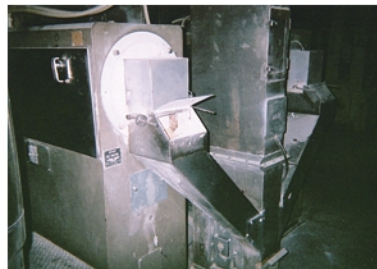
MDA静電気除電装置取り付け状況 (クリンライト)
