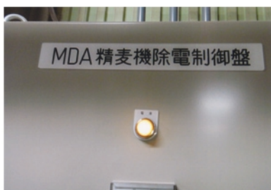
MDA精麦機除電集中制御盤
