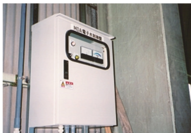
MDA電子水制御盤 (洗浄用)
