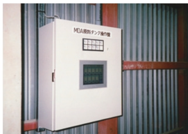
MDA原料タンクタッチパネル操作盤
