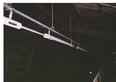
工場の天井に電子シャワー空気浄化装置MX-9型を設置。
