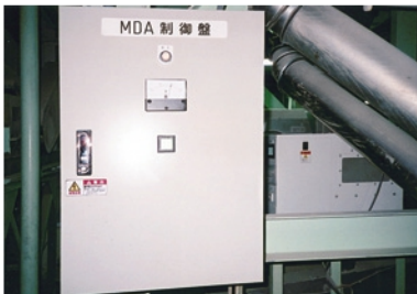
MDA静電気除電制御盤
