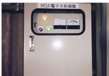
MDA電子水制御盤 (ボイラー用)
