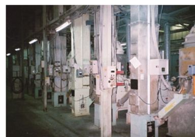
MDA静電気除電装置を設備 (精麦機 12台連座)
