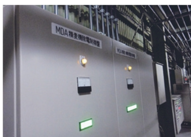
MDA精麦機除電集中制御盤
