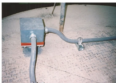
原料タンク上部MDA配管状況。
