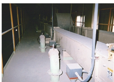
MDA製品タンク上部電子供給配管状況
