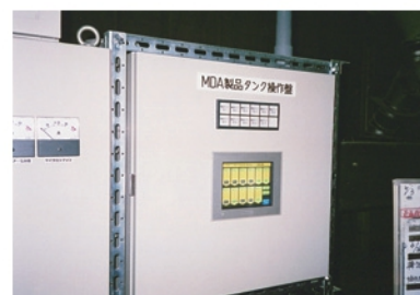
MDA製品タンクタッチパネル操作盤
