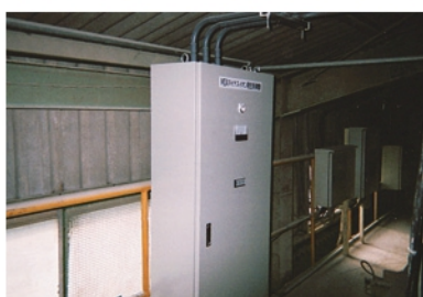
MDA製品タンク電子供給集中制御盤
