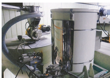
MDA静電気除電装置取り付け状況 (パック詰包装機)
