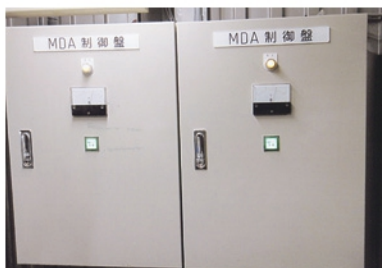
MDA静電気除電制御盤
