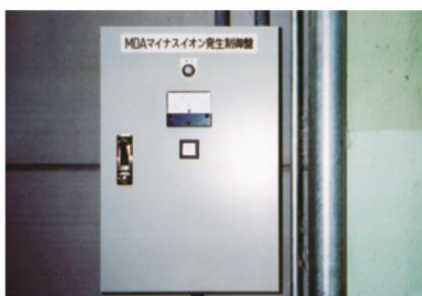
MDA原料制御盤
