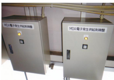
MDA冷蔵庫制御盤
