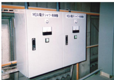
MDA電子シャワー制御盤
