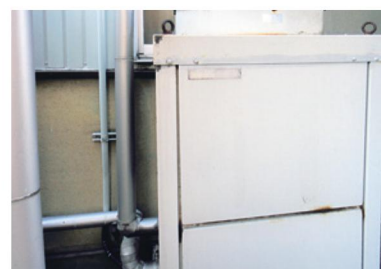
チラー（電子水の冷却装置） 水温を4℃に冷却して練り水や加工 用水として使用する。
