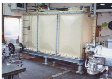
MDA電子水全自動製造給水タンク (電子水)
