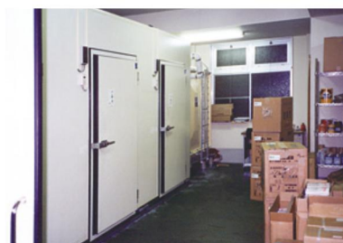
MDA電極板を設備した冷蔵庫
