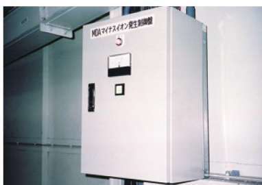
MDA浸漬制御盤
