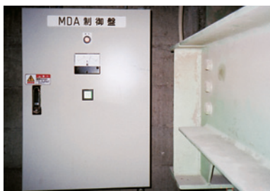
MDA電子発生制御盤
