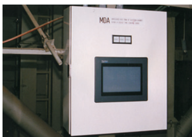
もち玄米タンクMDAエージング タイム操作盤
