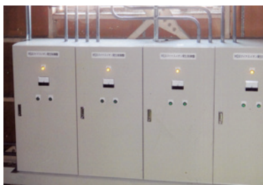
MDA電子発生集中制御盤
