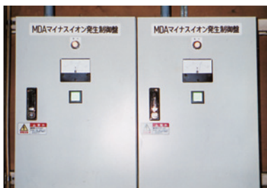
MDA電子シャワー空気浄化制御盤
