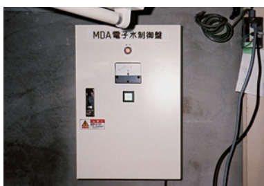
MDA電子水制御盤
