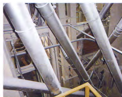
シュートパイプの静電気発生を中和します。
