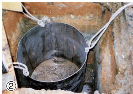
② 掘削した穴の中に炭素埋設用の型枠をセットする。
